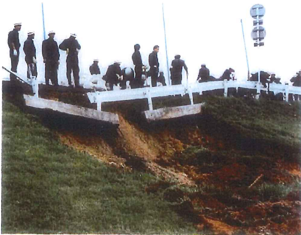
写真 12.1 ガードレールを堤防法肩付近に設けたときの被災例
